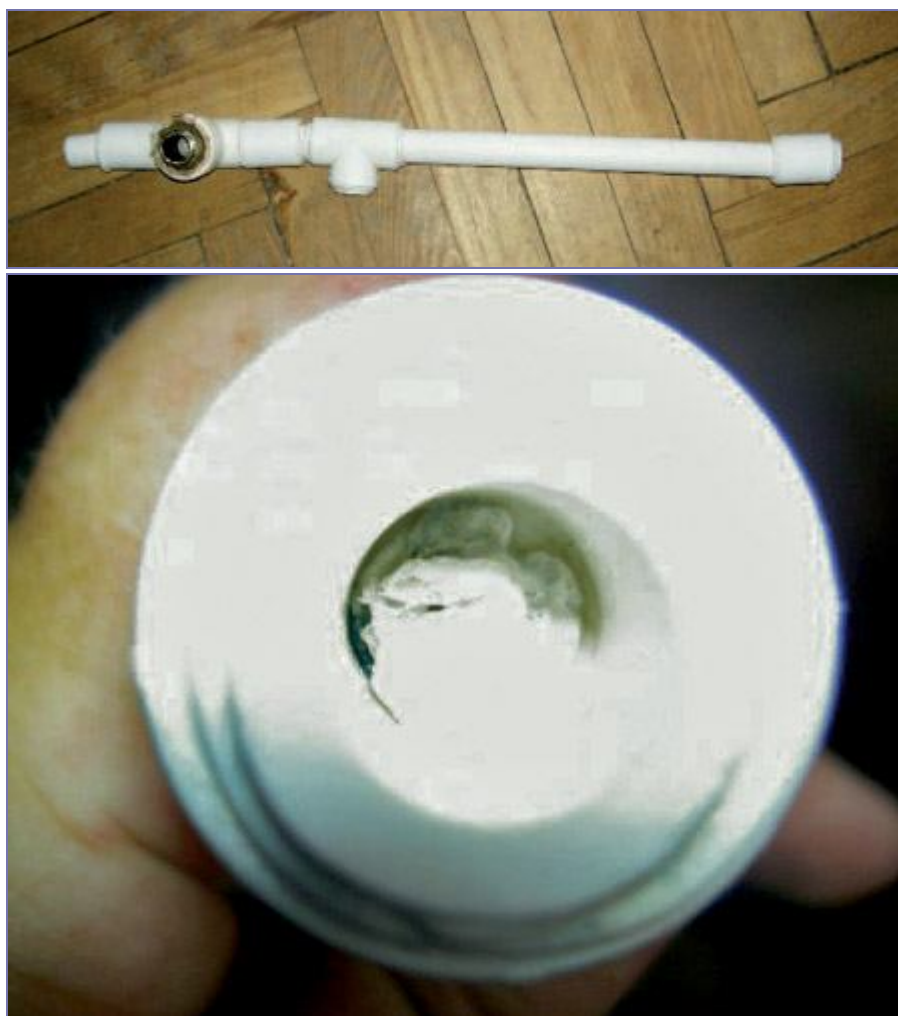
Зауженное проходное сечение трубы из полипропилена в результате неграмотного монтажа (участок стояка, вырезанный при капитальном ремонте дома)
